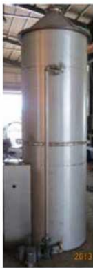
脱臭 尾气处理塔
